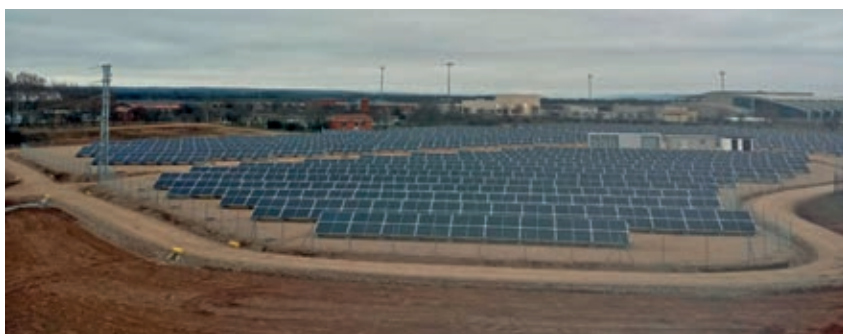
Planta Fotovoltaica en el aeródromo militar de León
