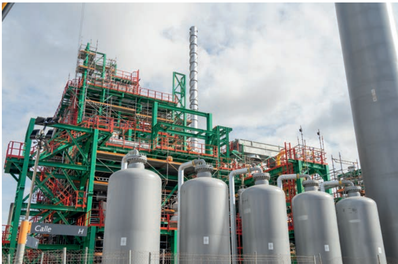
Planta de biocombustible de REPSOL, dentro del complejo de la refinería de Cartagena. (Imagen: REPSOL)
