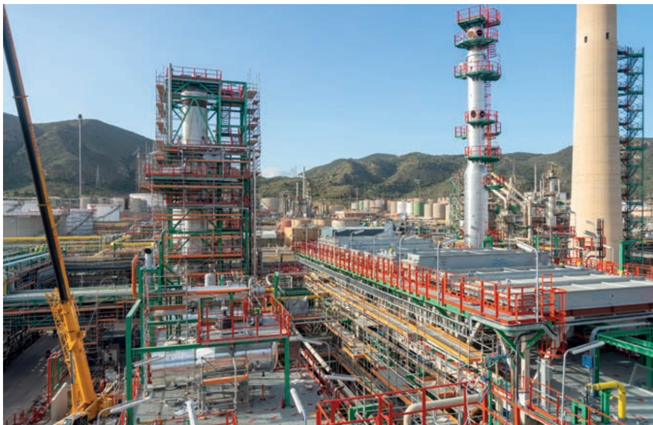
Planta de biocombustible de REPSOL, dentro del complejo de la refinería de Cartagena. (Imagen: REPSOL)
