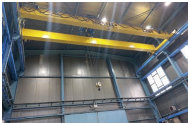
Puente-grúa de 12,5 Tm
